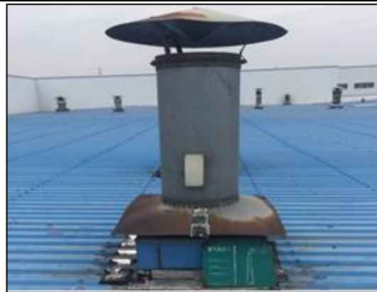
排气筒标识牌
